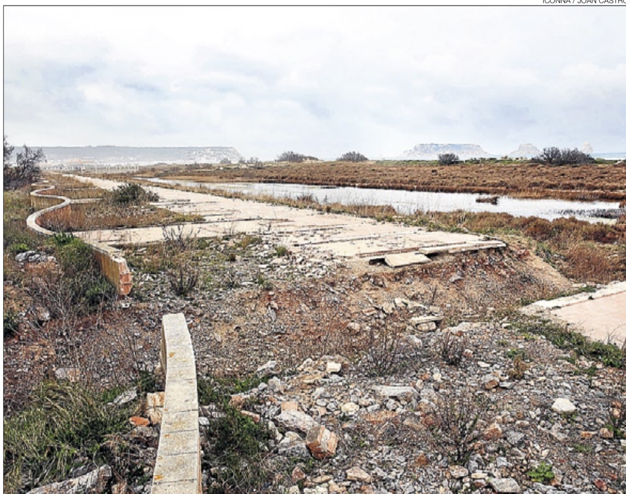
►► Rastre de formigó ► El paratge de la Pletera, a l'Estartit, esquitxat de plaques de ciment descompost.
